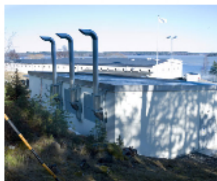
Görvälnverket, Norrvatten. 3*1500 kVA
